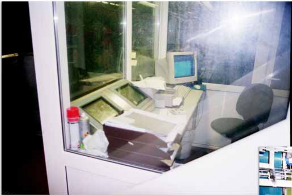
Leitstände für die kompletten Betriebsabläufe.
