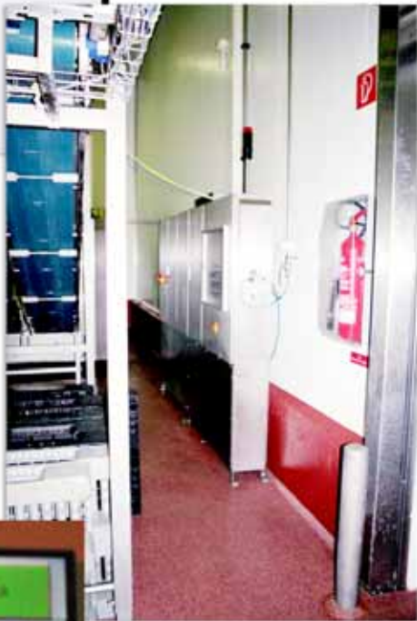
SPS-Steuerungen in moderner, branchenbezogener Ausführung.
