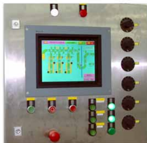
Steuerung der Anlagen
